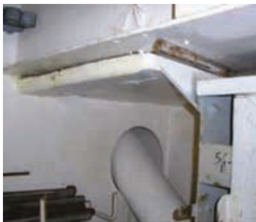
El amianto recubría paredes, techos y separados en zonas de uso y descanso
