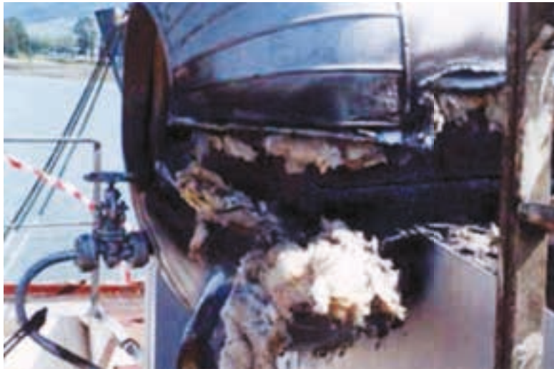
En la imagen se aprecia en detalle la borra de amianto que estaba presente en los aislamientos de maquinaria
