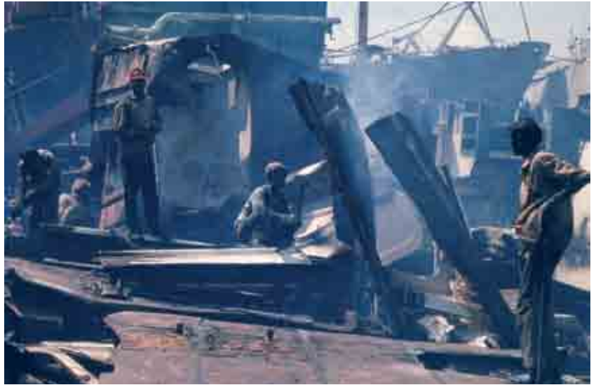
Muchos de los buques que contenían amianto se derivaron para su desguace a países en vías de desarrollo donde se manipulan sin ninguna precaución. Greenpeace
